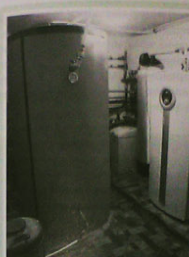
Технічне приміщення будівлі (зліва: акумулятор теплової енергії, справа: тепловий насос)
